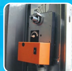
Автоматический привод управления вентиляционными жалюзи
